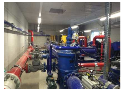
Bild 3: Filteranlage in der Pumpstation
